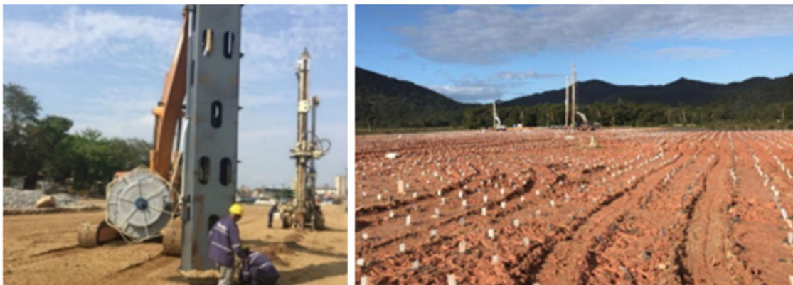
Figura 6.3.1.8-5 – Obra Similar Sobre Solos Moles: Implantação de Geodrenos Fibroquímicos no acesso à Rodovia Anchieta 4 - Prefeitura de Santos
